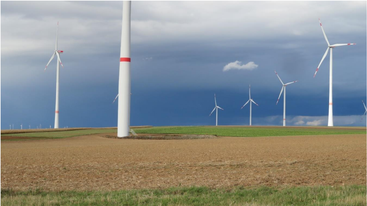
Bild 37: Windkraftwerke bei Biedesheim/Pfalz
