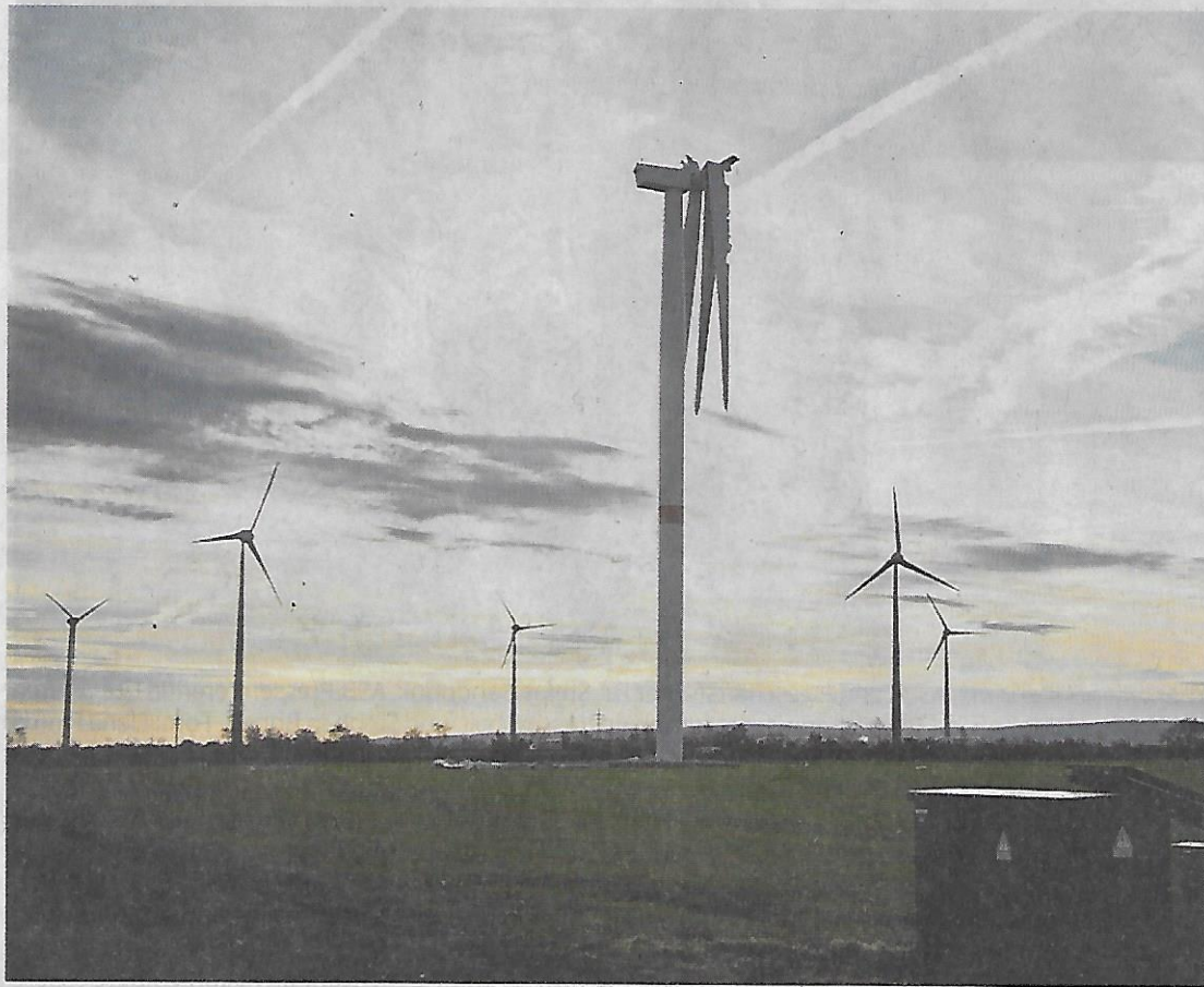
Die Beschädigung am 150 Meter hohen Windrad bei Mülheim-Wichterich fällt sofort ins Auge.
